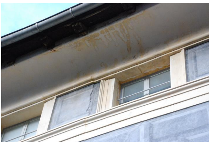
Danni alle facciate (bene culturale protetto)
