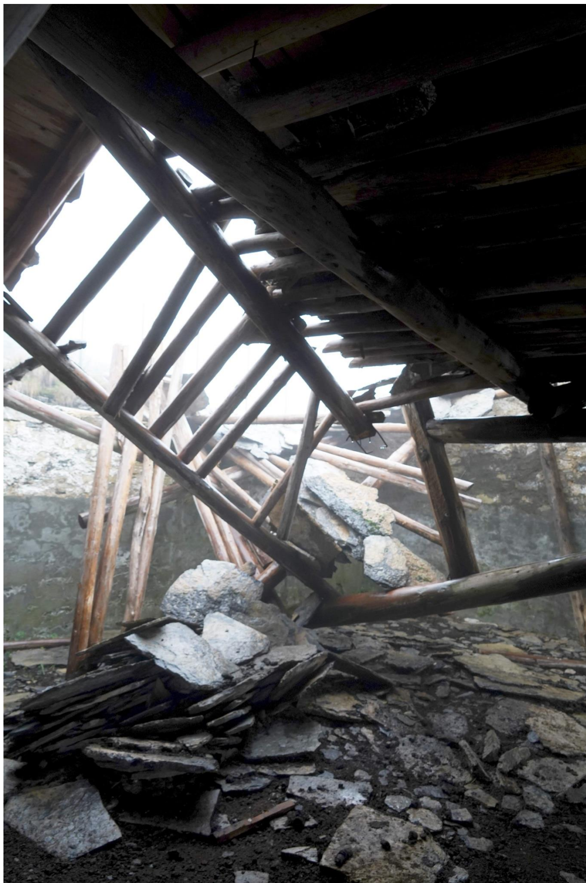
L'entità del danno alla carpenteria e alla copertura.
