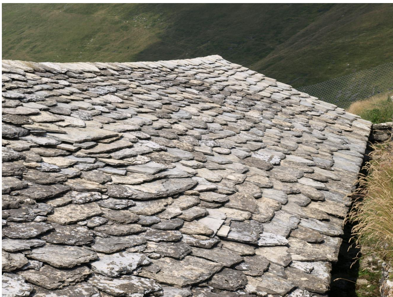
Dettaglio del tetto in piode che si intende restaurare conservando l'aspetto originario
