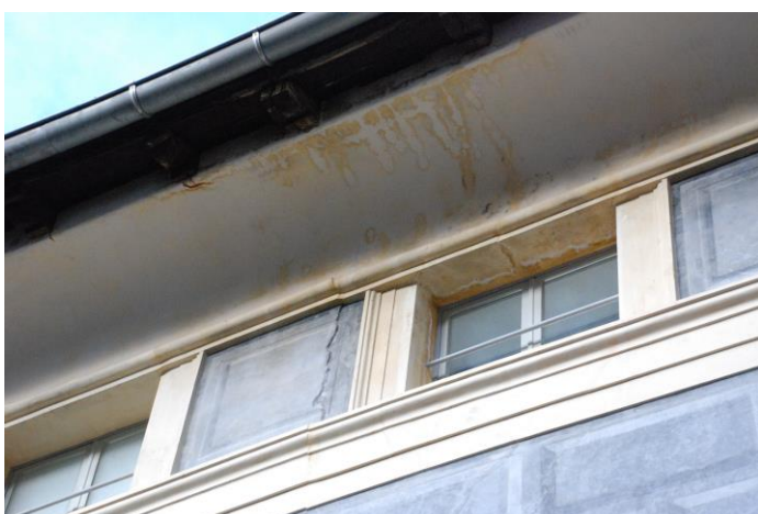
Danni alle facciate (bene culturale protetto)
